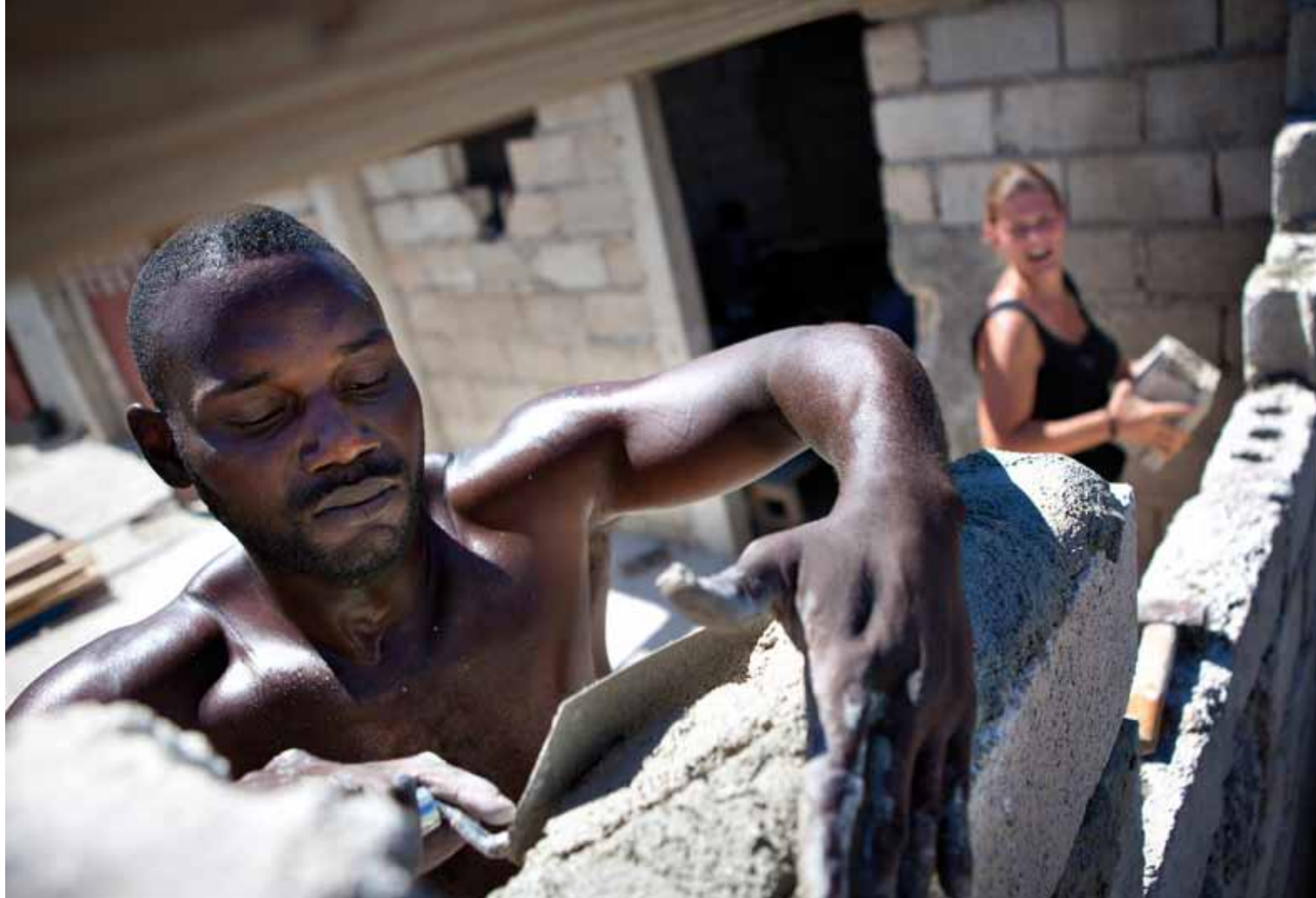
Teamwork Rebecca und Jhonson setzen neue Mauersteine in der Emes-Schule. Die deutsch-haitianische Zusammenarbeit funktioniert
